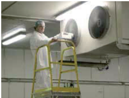
Erfassung Hygienierisiko an Umluftkühlaggregaten
