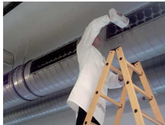
Erfassung Hygienierisiko an der Zuluftanlage
